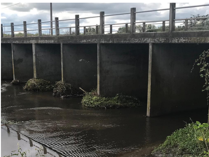
Figura 5. Obstrucción de cauce.
